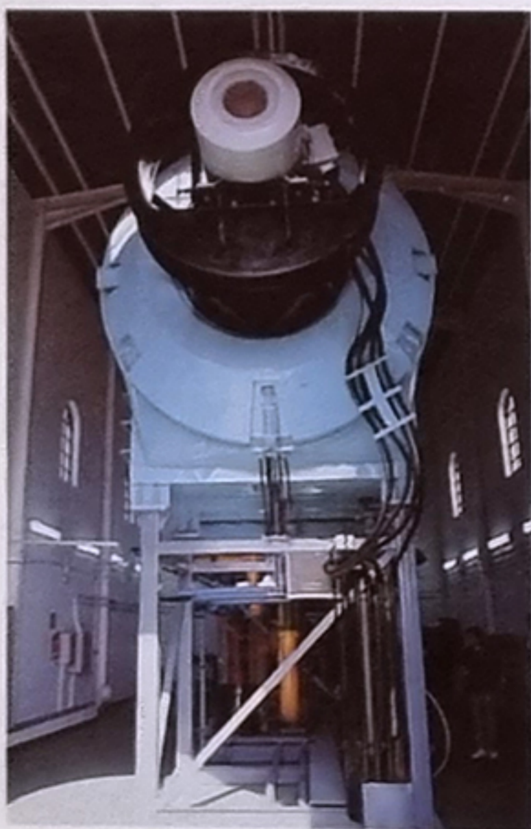
Vista interior de la Planta Desaladora.
